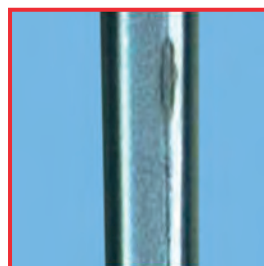
Corrosión de contacto: Acero inoxidable/latón
