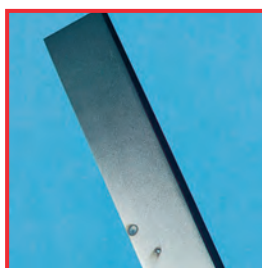
Ejemplo de corrosión de picadura
