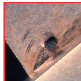
Ejemplo de corrosión de picadura
